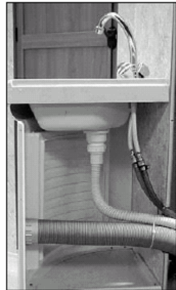
I collegamenti acqua calda/fredda del lavello bagno, il tubo di scarico acque scure, la tubazione dell'aria forzata.
