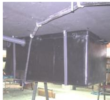
SERBATOIO ACQUE SCURE
