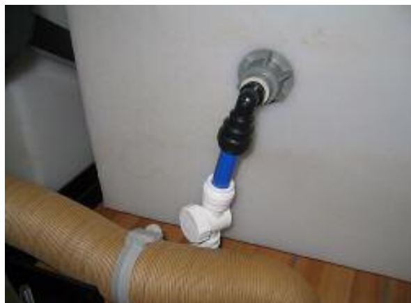
VALVOLA SCARICO PARZIALE SERBATOIO
